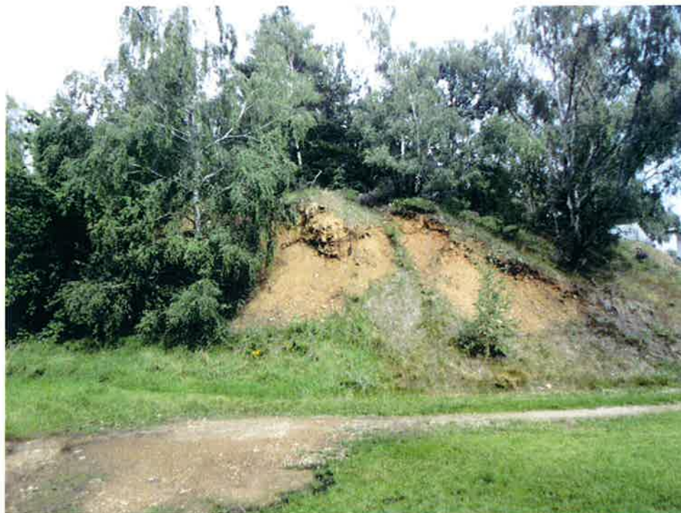
Foto 0014-1: Pohled na odtěžený svah od Z
